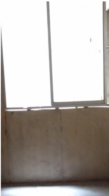
Ilustración 4. Luces entre vano y marco de ventana (Tacos de madera)
