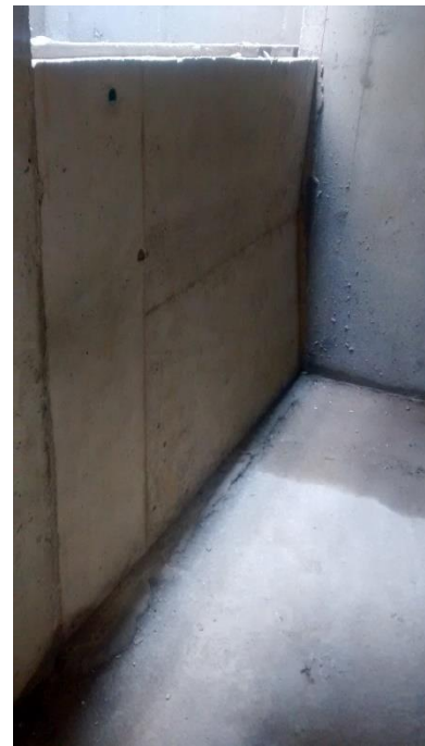
Ilustración 6. Desplome de muro.
