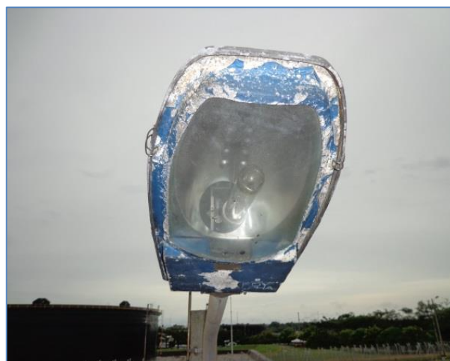
Ilustración 18. Estado físico de la carcasa de las luminarias
