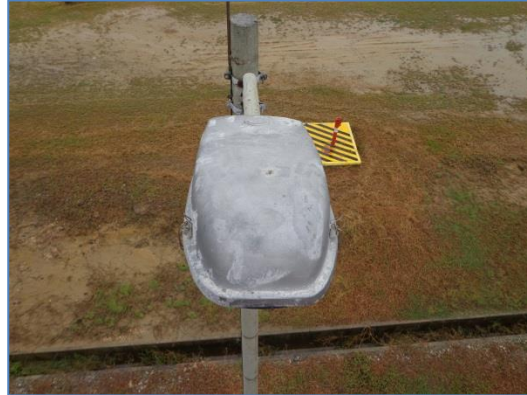
Ilustración 19. Estado físico exterior de la luminaria
