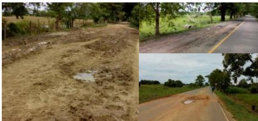
Imagen 55. Vía de acceso en mal estado, vereda Tosnovan, municipio de San Benito Abad.
