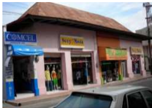
Imagen del 2007, cubierta de zinc corta y en estado de deterioro, falta de cielo raso exterior.
