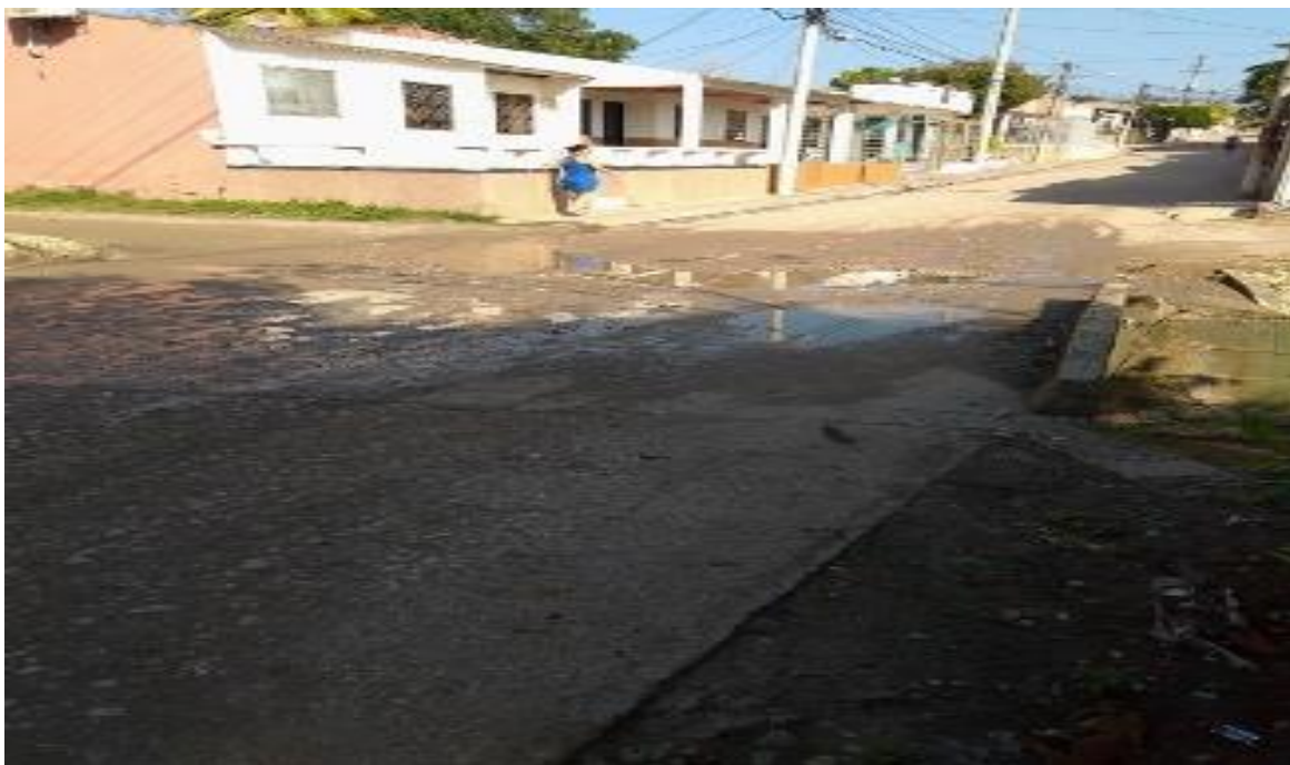
Imagen 34. Vías urbanas en mal estado – Carrera 7c.
