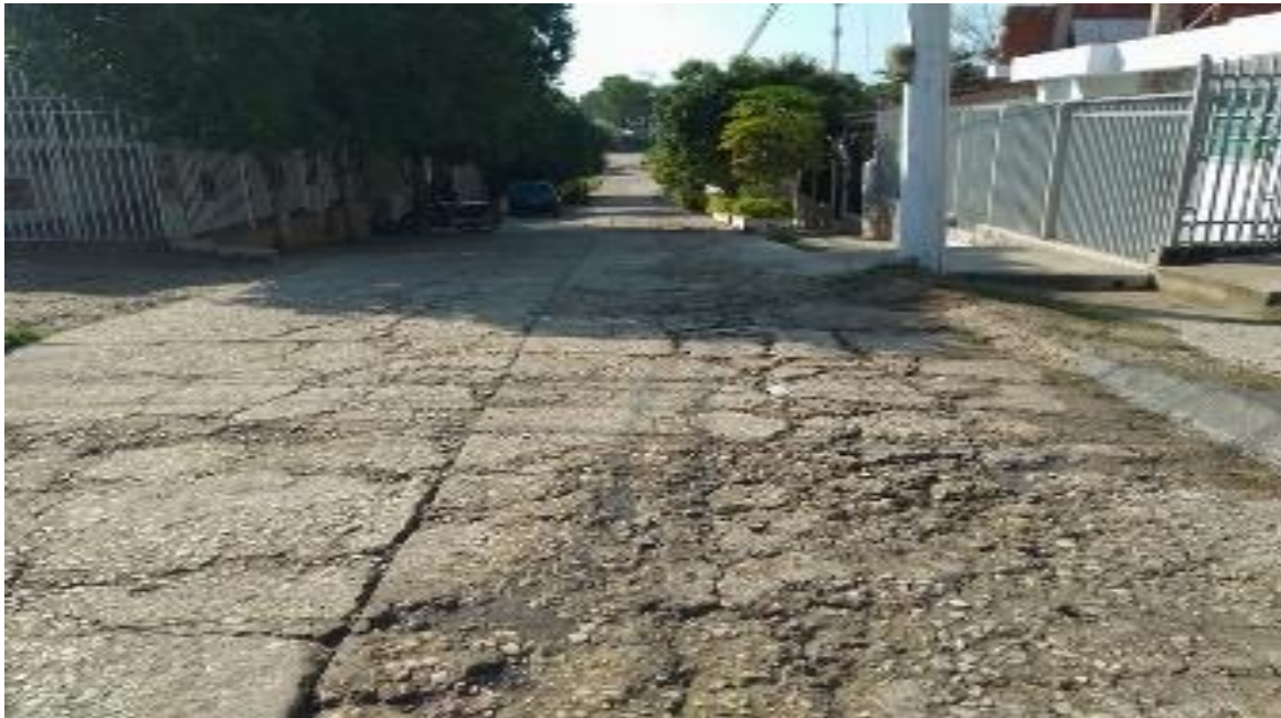
Imagen 33. Vías urbanas en mal estado – Carrera 7.
