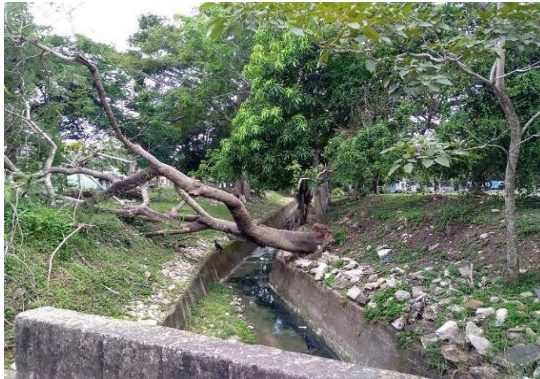
Imagen 10. Arroyo El Cortijo sector canchas. Fuente: Elaboración propia.
