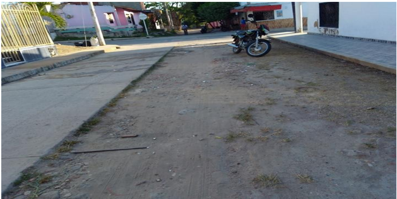
Imagen 32. Vías urbanas en mal estado – Calle 29b, Vía sin pavimentar.
