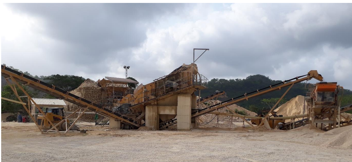
Figura 21. Planta trituradora AGRESUCRE. Fuente: Elaboración propia 2017.
