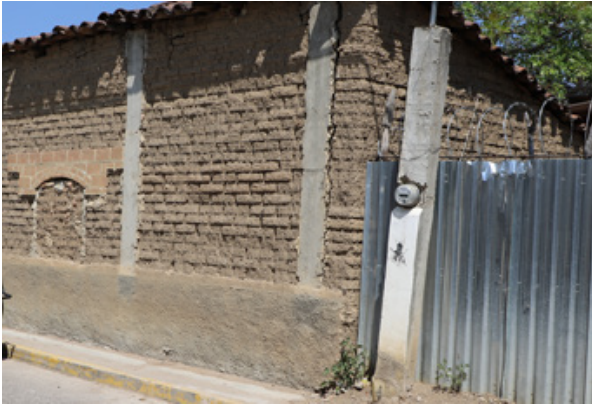
Figura 20. Vivienda vernácula con diferentes intervenciones sin asistencia técnica correcta constructiva.
