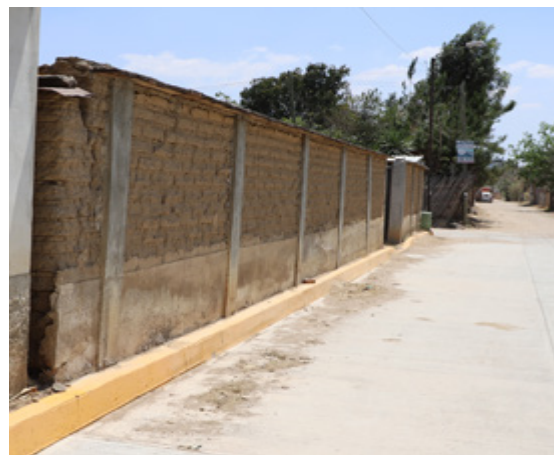
Figura 19. Muro perimetral de adobe en vivienda vernácula, se observa la inclinación del muro, intervinieron con columnas de concreto armado, falta de asistencia técnica correcta constructiva. Fuente: Autores. 2020.
