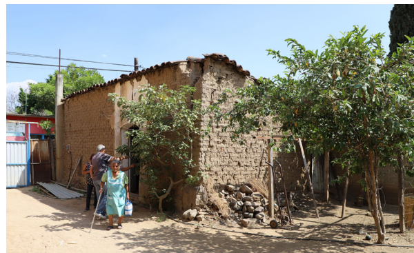
Figura 13. Vivienda con características de arquitectura vernácula con adobe en riesgo de colapso. Fuente: Autores. Año 2020.
