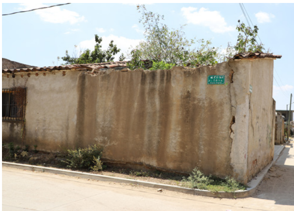
Figura 17. Vivienda Vernácula inhabitable por falta de techo. Fuente: Autores. Año. 2020.
