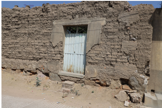
Figura 15. Vivienda con características de arquitectura vernácula con adobe, en ruinas. Fuente: Autores. Año 2020.
