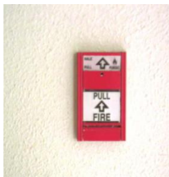
Palancas de Incendio
