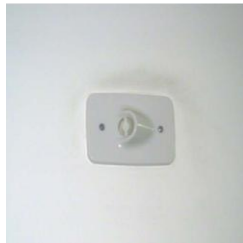
Alarma de Incendio
