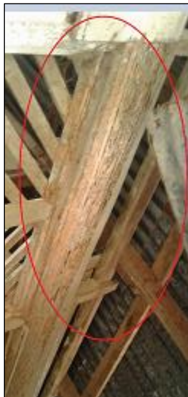
Figura 51. Patología por insectos xilófagos coleópteros. Fuente de elaboración Propia (2017).
