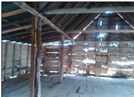
Figura 40. Vista del estado de deterioro del segundo piso. Fuente de elaboración Propia (2017).
