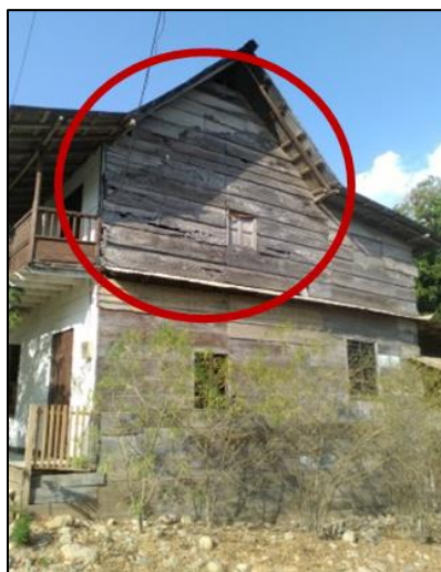
Figura 2. En esta imagen de su fachada lateral se aprecian patologías constructivas existentes que afectan las condiciones de vida de los que habitan en ella. Fuente de elaboración propia (2017).
