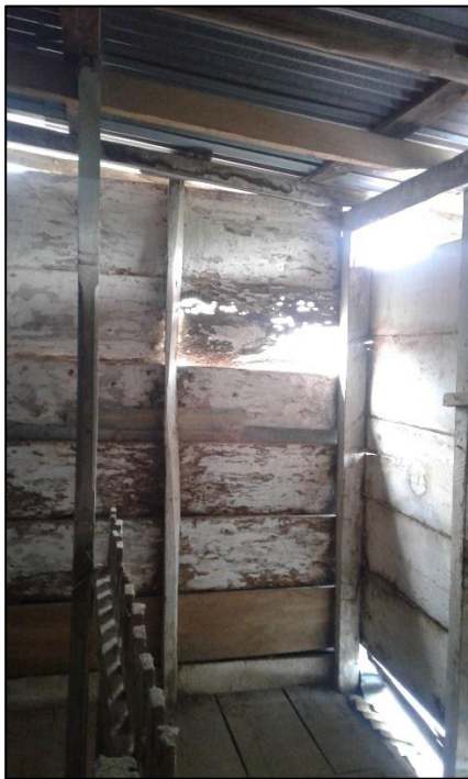
Figuras 3, 4 y 5. Se aprecia de forma detallada el alto deterioro que posee la vivienda en su interior. Fuente de elaboración propia (2017).
