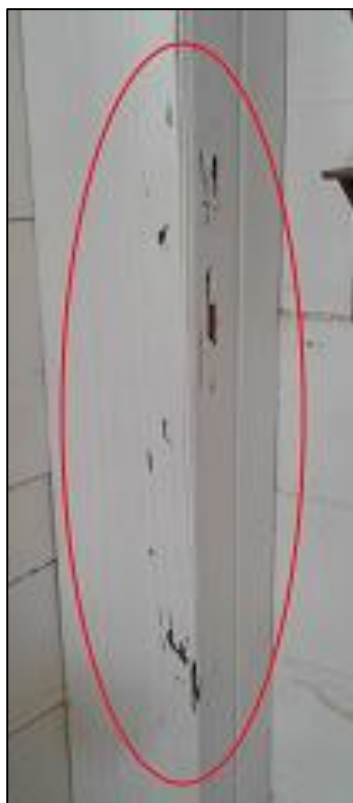
Figura 50. Patología por insectos xilófagos coleópteros. Fuente de elaboración Propia (2017).
