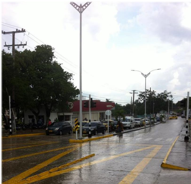
Figura 55. Fotografía de la Intervención Semafórica. Fuente: grupo investigador.
