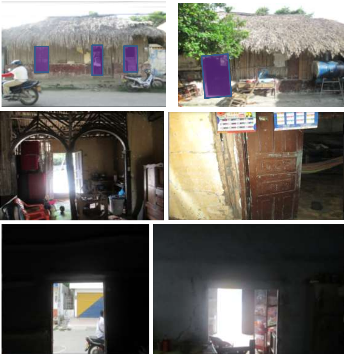
Imagen 75. Aberturas de la fachada principal, fachada posterior, sala, cocina, cuarto y vano de sala de la vivienda de la familia Caldera.
