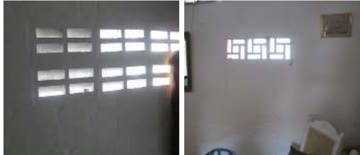
Imagen 52. Rejilla de ventilación en hormigón casa familia Casillo.
