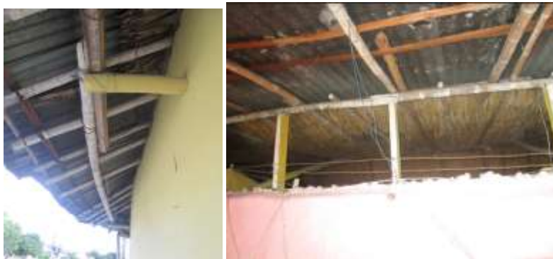
Imagen 60. Sin cielo raso exterior e interior casa familia Salazar Paternina
